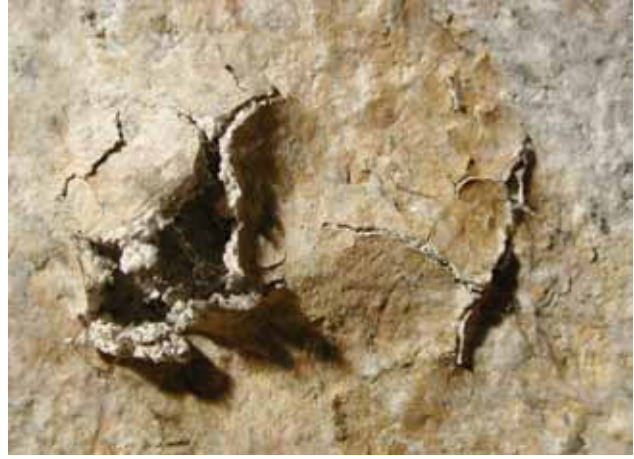
[17] Blasenförmige Deformationen der oberen Putzhaut, Bildbreite ca. 8 cm
