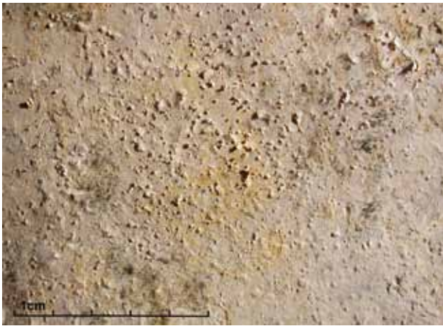
[14] Kleinteilige Abhebungen und Ausbrüche über Zuschlagspartikel
