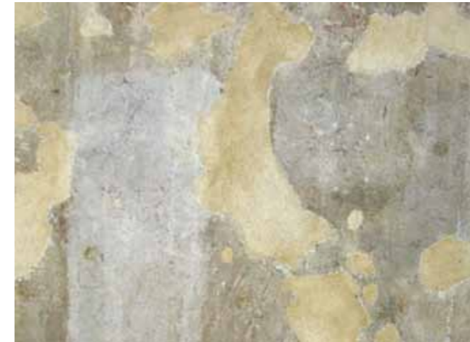
Abb. 17: Probefläche Nr. 02 nach der Behandlung, Vergleich der Testflächen Niederdruckverfahren (links) und Kompressenbehandlung mit Diffusionsdruck (rechts)
