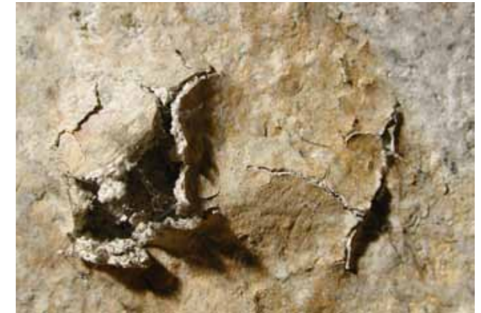
Abb. 4: Blase mit deformierter Putzhaut, Gewölbmalereien in der Krypta der Stiftskirche St. Servatius in Quedlinburg
